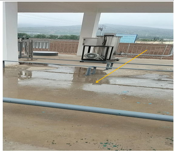
臭氧接触池（位于地下）
