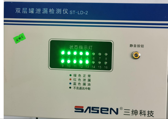
防渗漏在线监控系统
