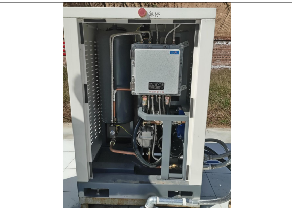
油气回收处理系统
