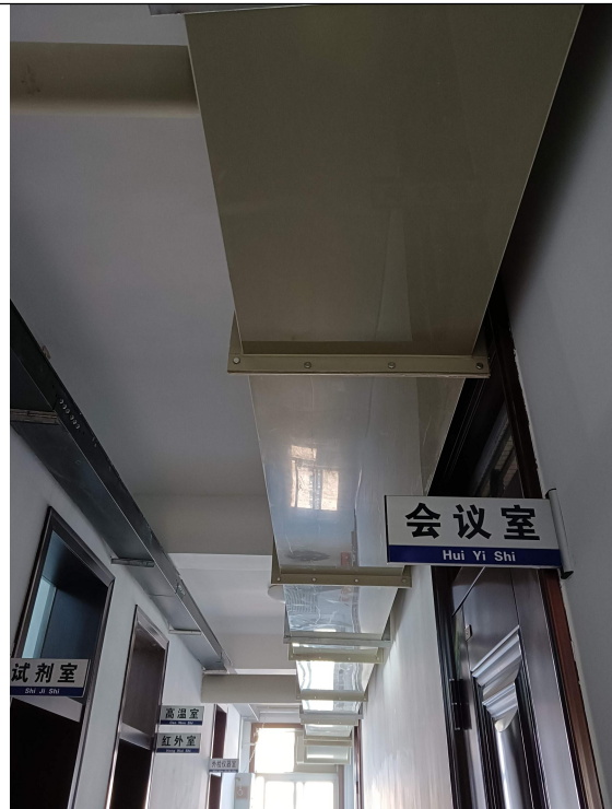
项目通风排气系统
