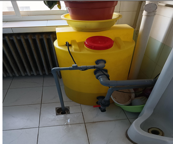
实验室废水暂存罐（位于四楼）
