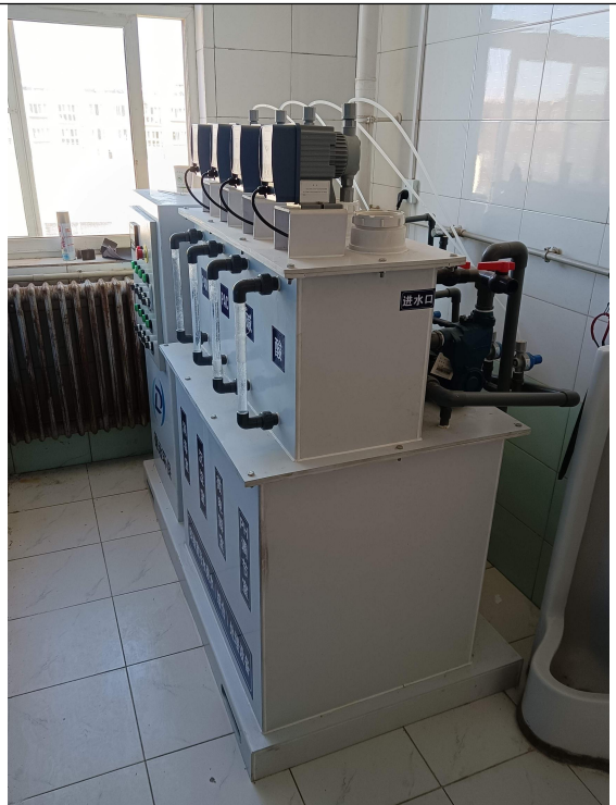
项目污水处理设施（位于五楼）
