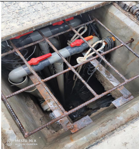
污水处理站地下设备间
