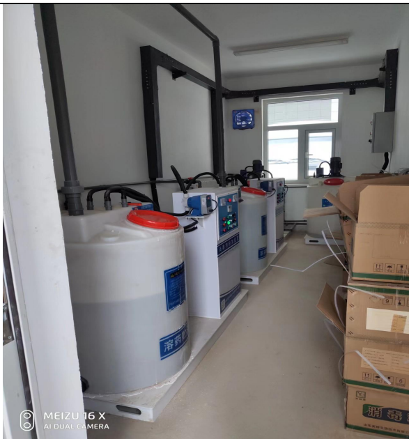
污水处理站加药设备间
