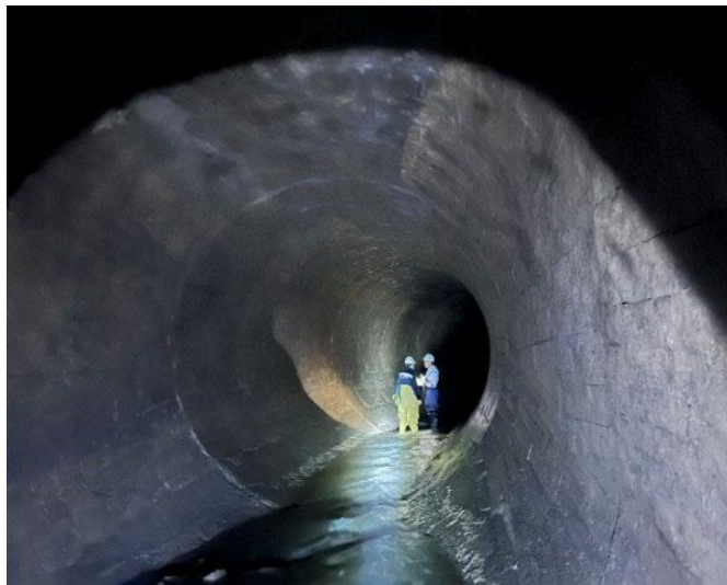
图 3.4-13 现状泄洪洞内衬情况 1
