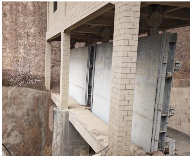
图 3.4-9 控制闸闸顶高程不足
