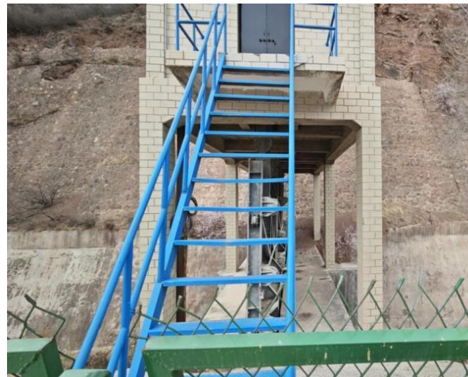
图 3.4-10 排架结构局部老化破损
