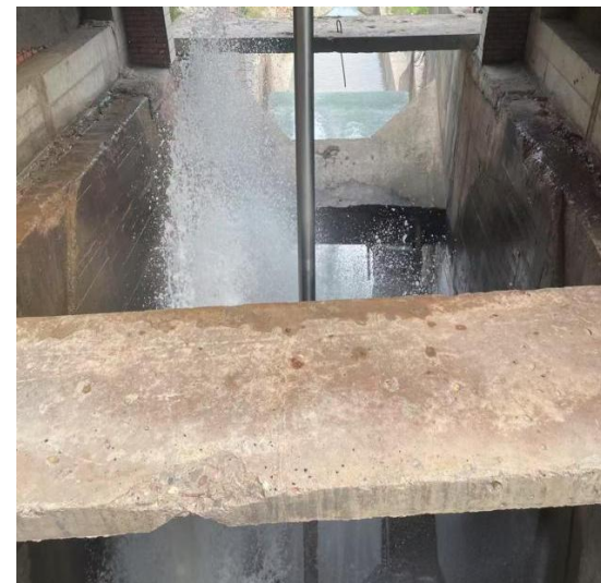
图 3.4-20 出口工作闸门关闭不严
