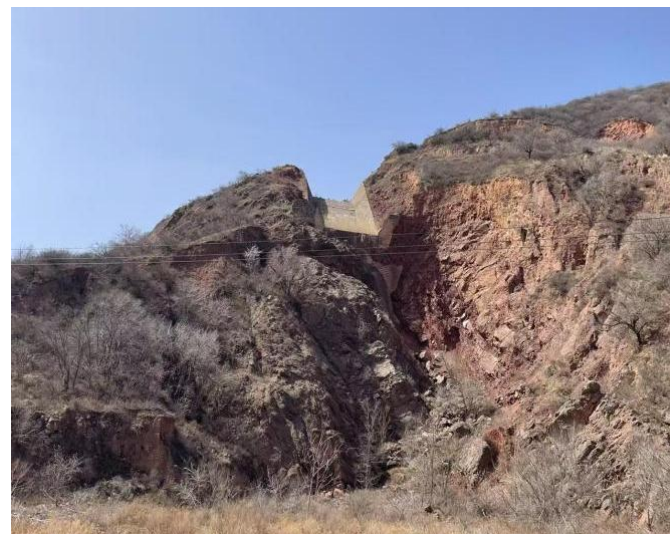
图 3.4-8 溢洪道挑流段掏刷脱空情况
