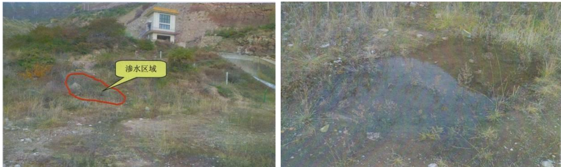
图 3.4-2 大坝坝后左侧坝脚渗漏情况
