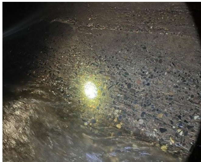
图 3.4-16 现状泄洪洞洞身骨料外露
