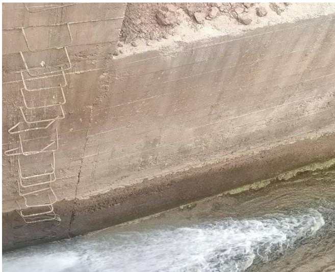
图 3.4-21 出口扩散段砼剥蚀
