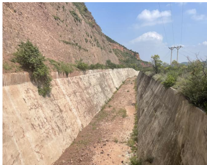
图 3.4-7 溢洪道边坡掉块情况
