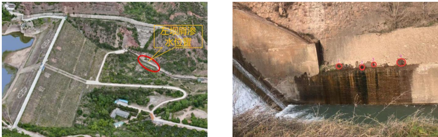
图 3.4-3 左坝肩泄洪洞出口下游左侧边墙渗漏情况
