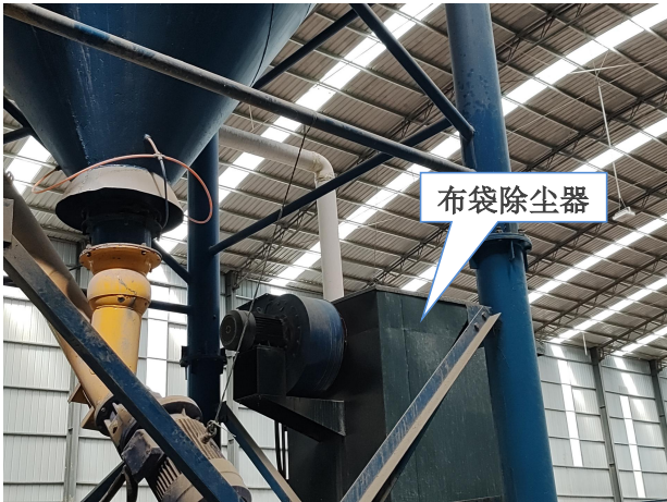
匀质保温切块生产线布袋除尘器
