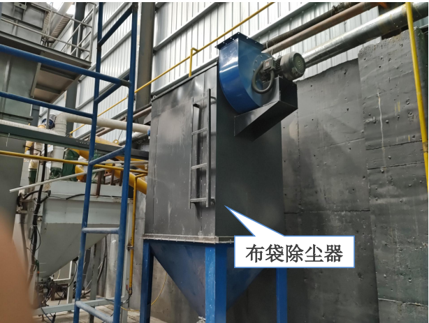
保温一体板生产线布袋除尘器
