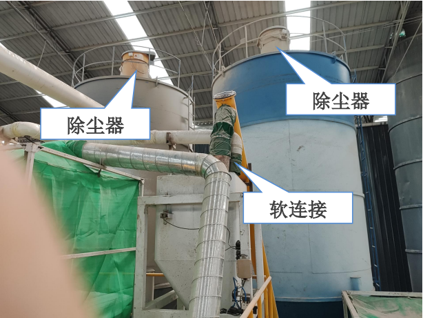
匀质保温切块生产线筒仓除尘器及软连接
