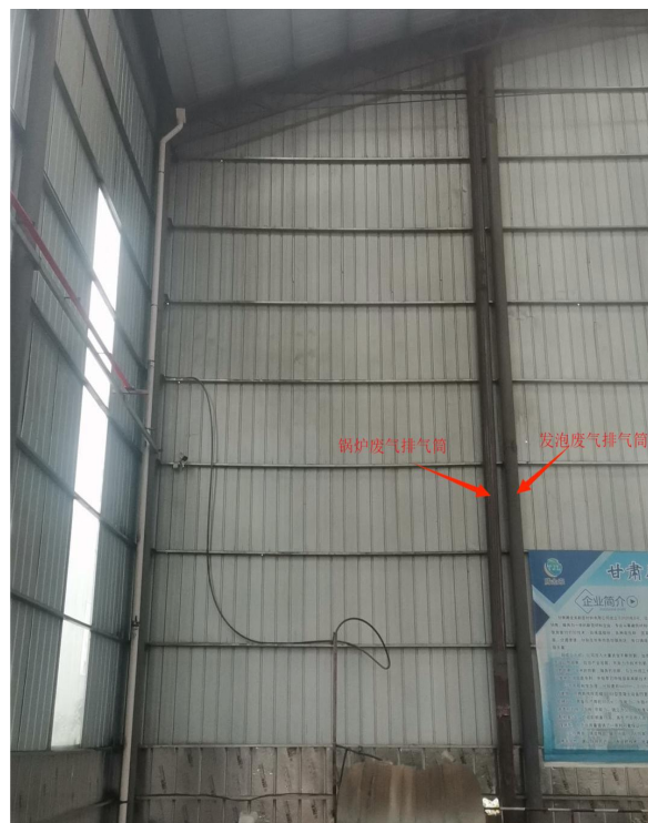
1.0t/h 柴油锅炉烟囱、发泡废气排气筒
