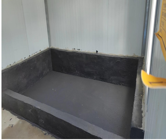
危废暂存间防渗及围堰
