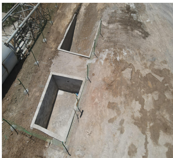
设备冲洗废水沉淀池（5m 3 ）
