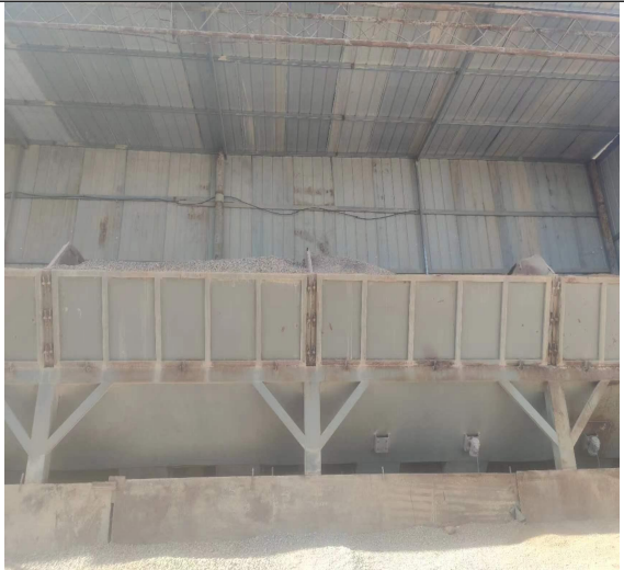
上料口 (配备喷淋)
